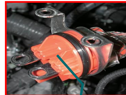
Høyspenningskabel fra HV - batteriet
